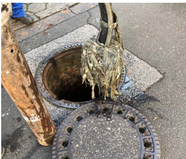
Abbildung 7: Verstopfter Kanal (Quelle: Hamburger Stadtentwässerung AÖR)
